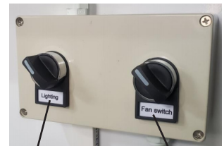
Interrupteur éclairage - Interrupteur ventilateur
