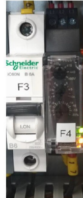
Fig. 12 : Alimentation électrique de la machine
